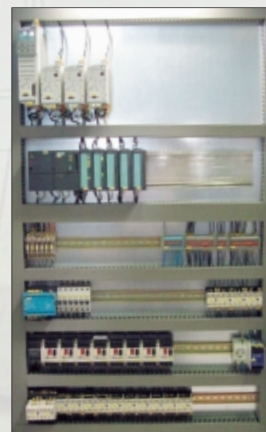
▶ Styreskab med standard Siemens S7 PLC.
